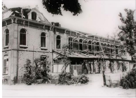
De Buitensocieteit zwaar beschadigd en het interieur is een ravage (Collectie Zutpense Musea)
